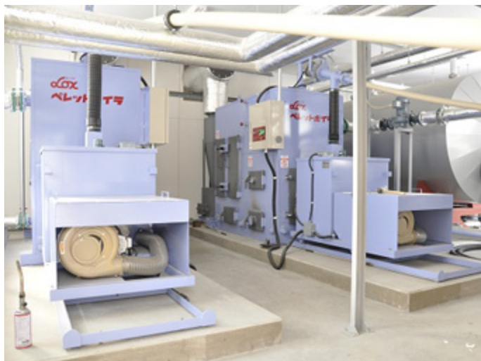
ボイラー棟内部
