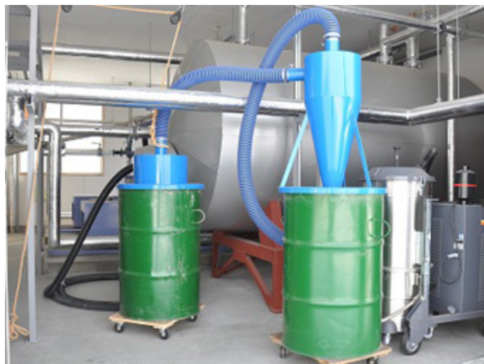
ボイラー棟内部
